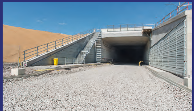
Bullerskyddspanel i tågtunnel, Gamla Uppsala
